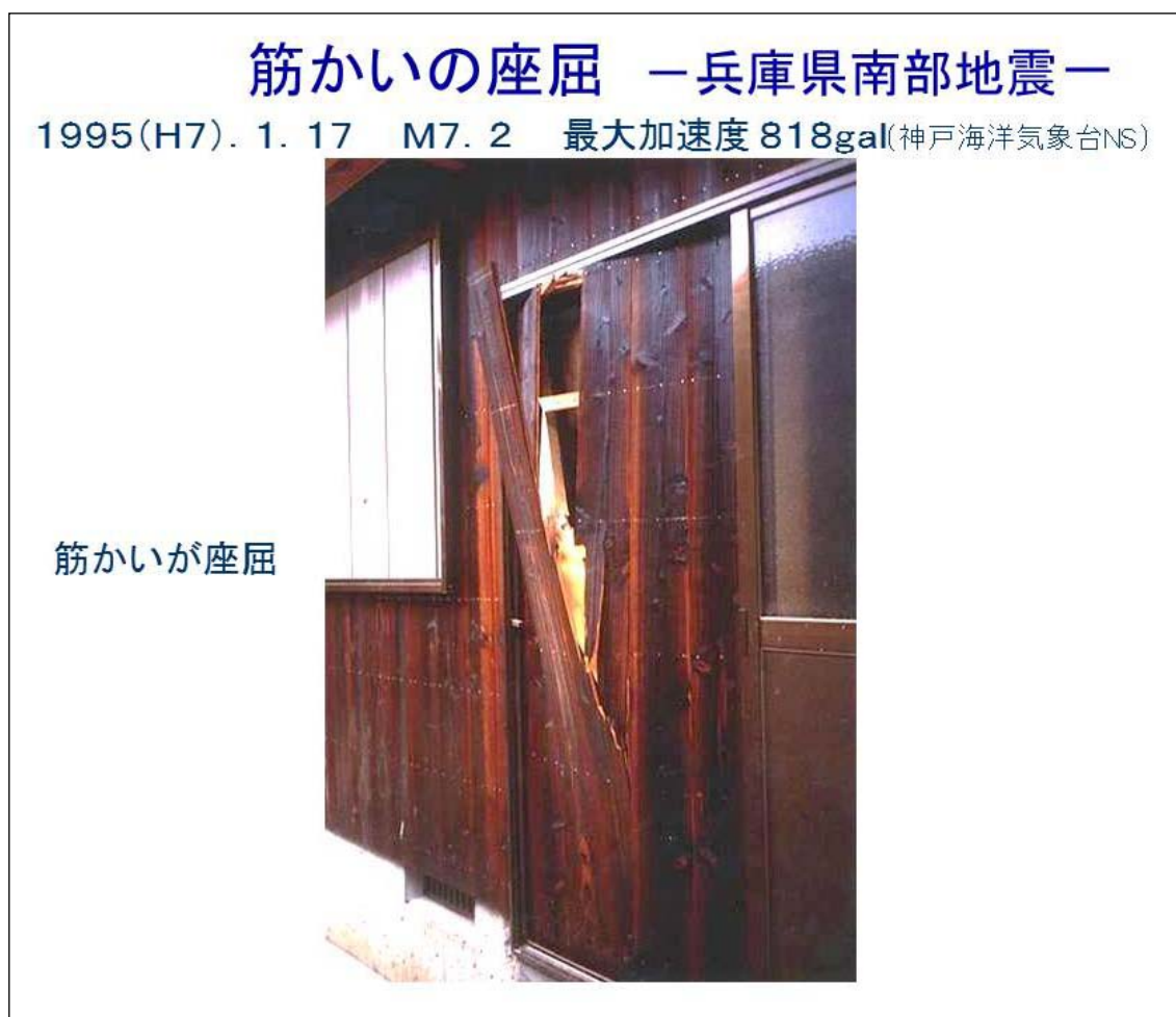
図 3-13 筋かいの座屈－兵庫県南部地震－
