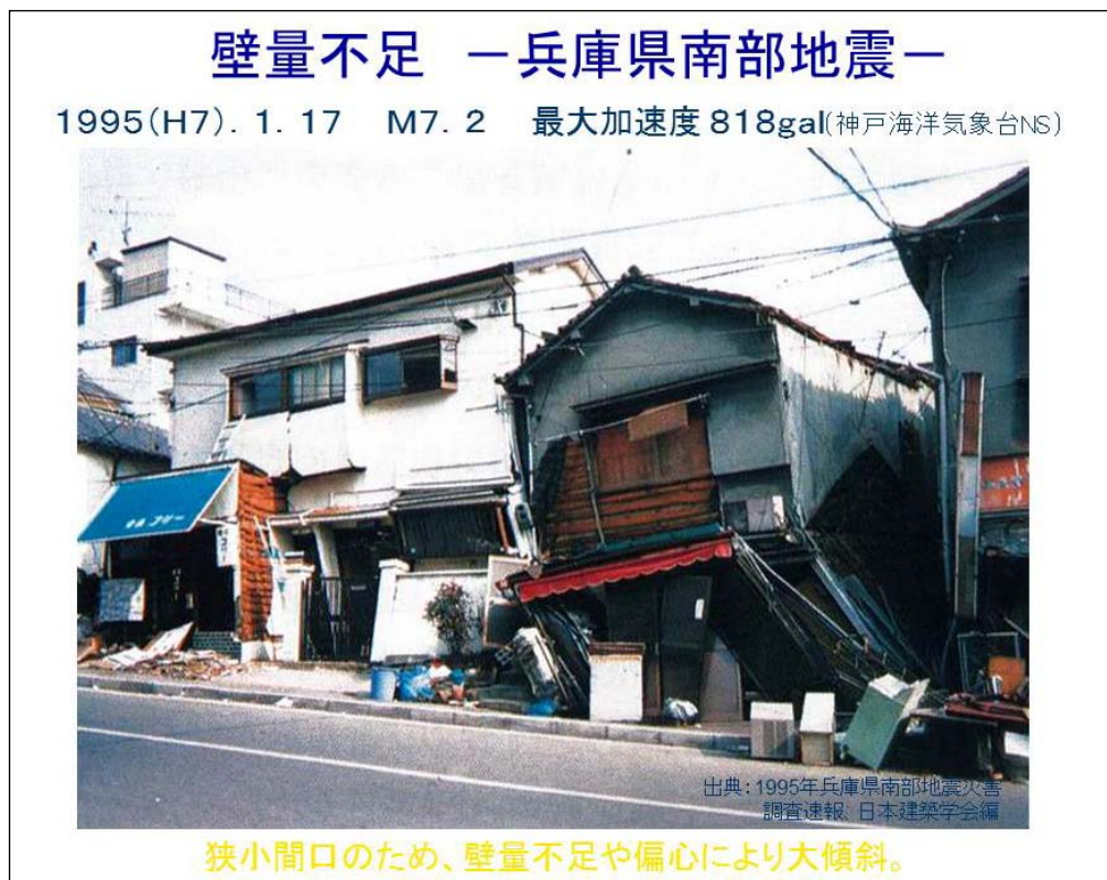
図 3-8 壁量不足一兵庫県南部地震一
