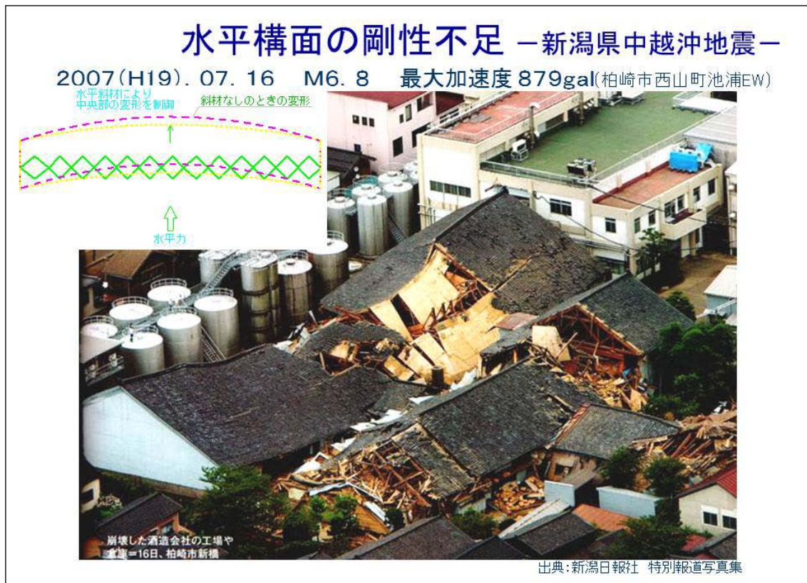
図 3-14 水平構面の剛性不足—新潟県中越沖地震—
