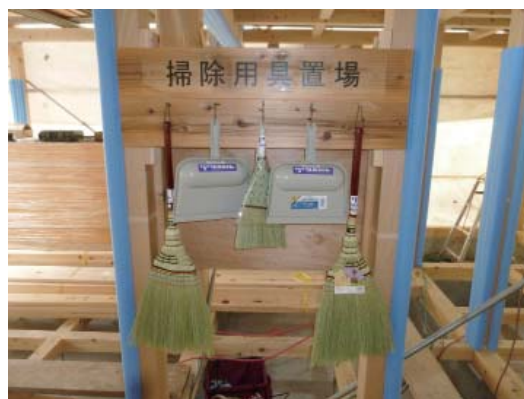
◎掃除道具設置例（内部）
