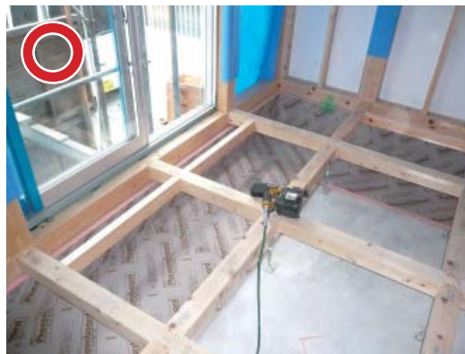
◎ 床下となる土間も掃除機掛けをしましょう
