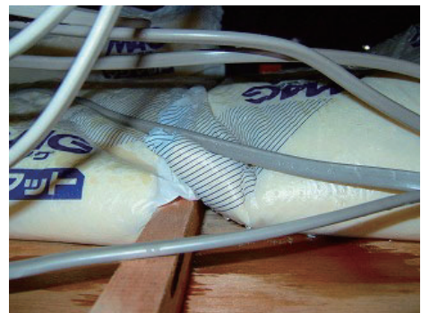
屋根裏の様子。水が断熱材や天井板を濡らす。
