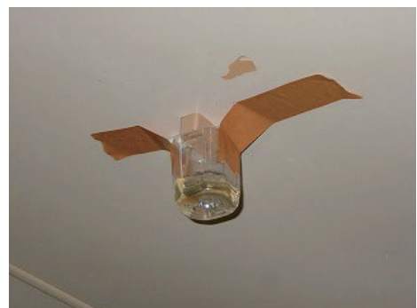
蛍光灯の天井ソケットから落ちる水をペットボトルで受ける。
